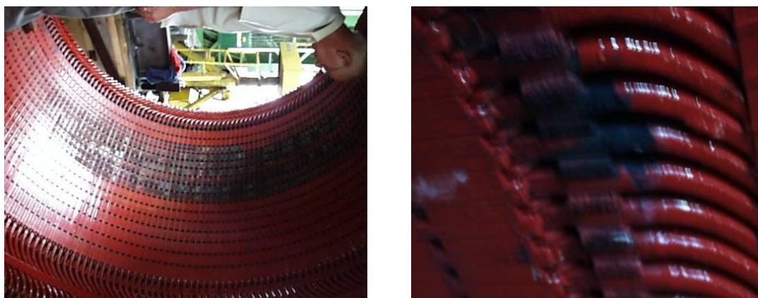
6. ábra A rotor beverődött a statorba. A stator vezetékai zárlatosak.
